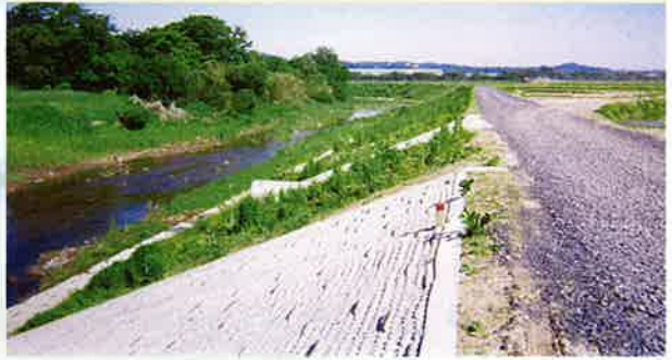
工事名：第2遊水池敷地内河川下流地区護岸工事 施主：国土交通省東北地方整備局岩手工事事務所
