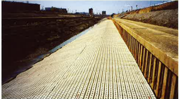
工事名：激甚災害対策特別緊急河川工事一級河川新川 施主：愛知県河川工事事務所
